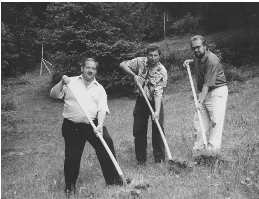
Spatenstich für das neue Reservoir Brandwald: Bauunternehmer Urs Niederberger, Baukommissionspräsident Pius Oertig und Uertevogt Paul Joller.
