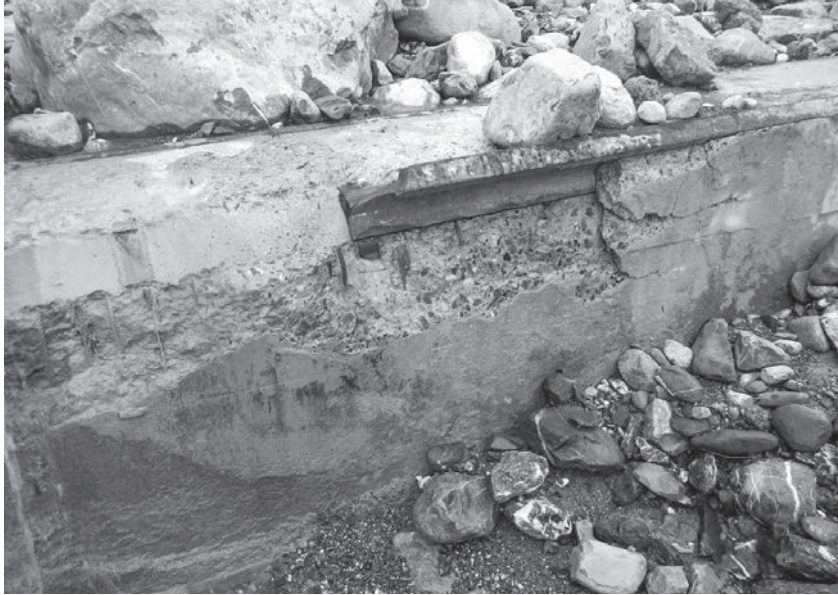
Beschädigte Sperre im Steinibach
