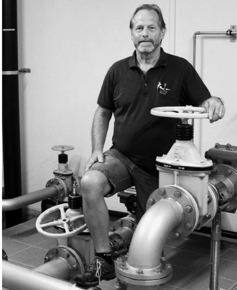
Alois Mathis im Wasserreservoir Chritzerli
