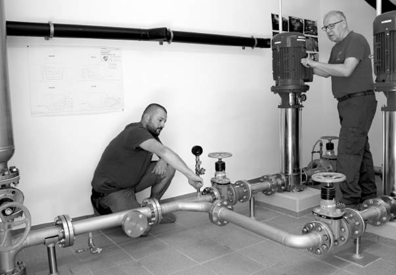
Vorbereitung für die Reinigung des Reservoirs, links Guido Niederberger, rechts Kurt Niederberger
